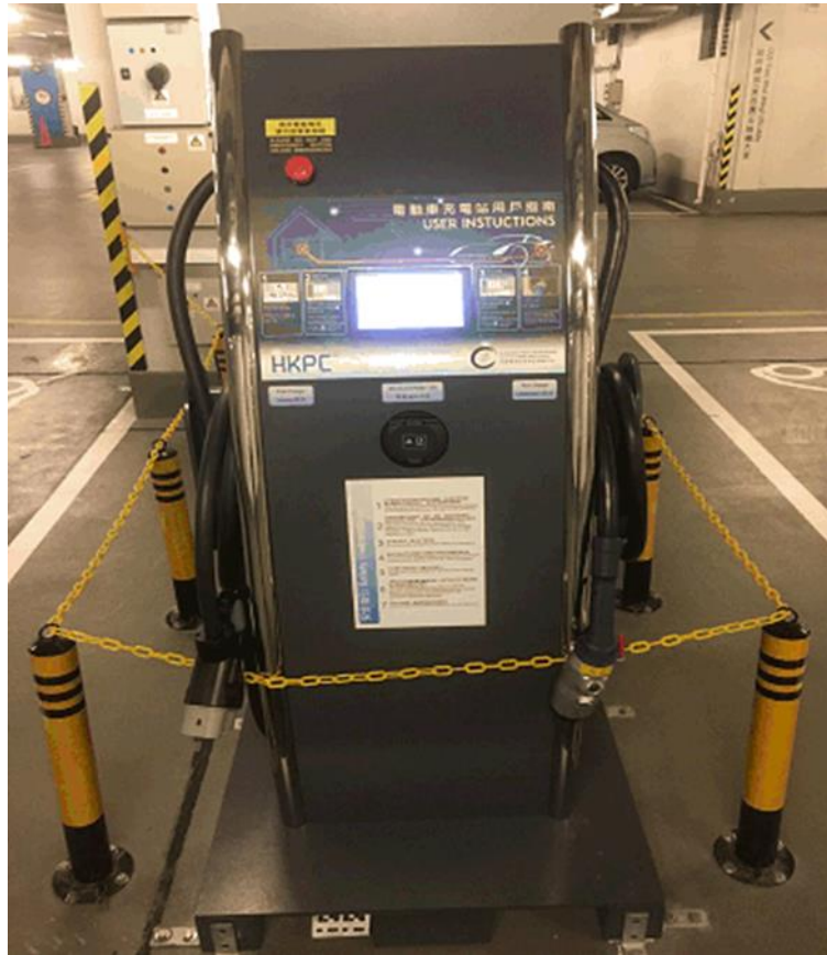
圖 2 — 電動車快速充電站
